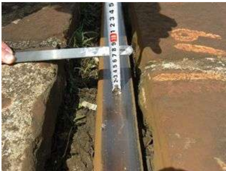
老朽化した軌道
