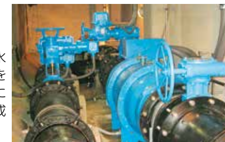
小水力発電設備
