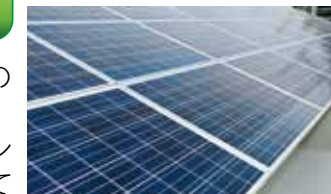
「歴史文化にぎわいプラザ」に設置された太陽光パネル
