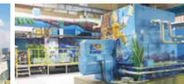
ごみ焼却時の排熱を利用した蒸気タービン発電機
