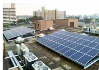
泉北下水処理場の太陽光パネル
