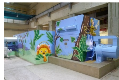
《東工場第二工場 発電設備》
