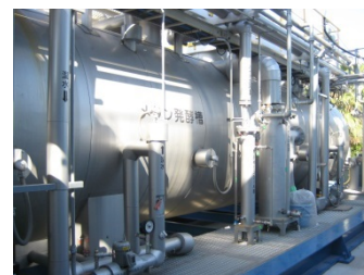
《メタン発酵施設》
