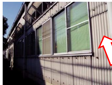
アスベスト含有シート波板（外壁仕上げ材）
