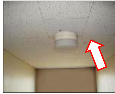
アスベスト含有石膏ボード（天井仕上材）
