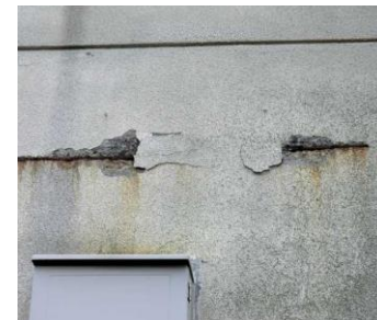
外壁の浮き、鉄筋露出
