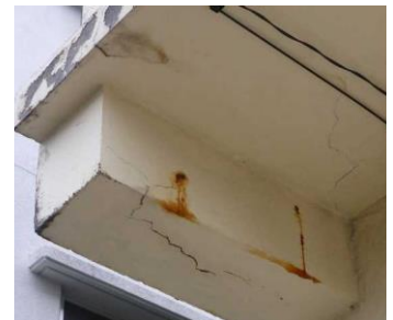
バルコニーのひび割れ、錆汁
