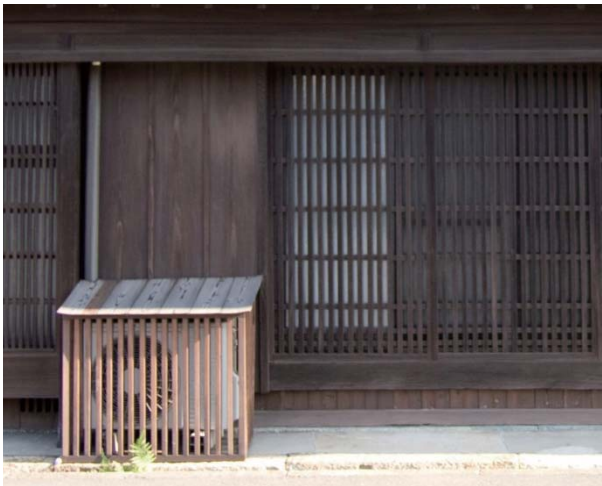
格子の目隠しで囲われた空調室外機
