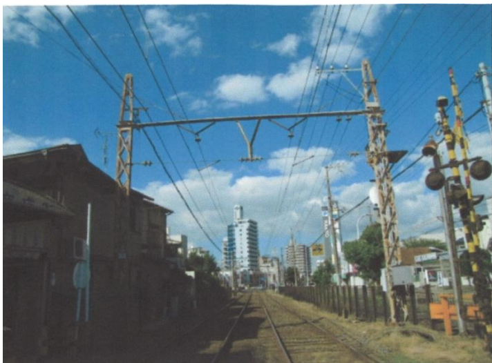
老朽化した電車線
