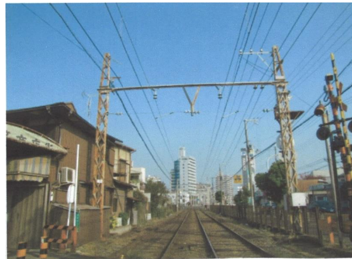
整備された電車線
