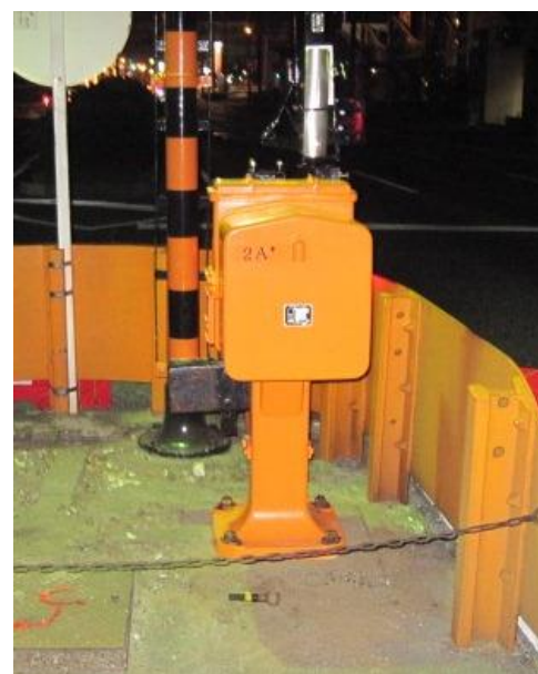
更新された踏切保安設備
