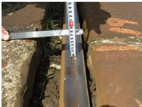
老朽化した軌道
