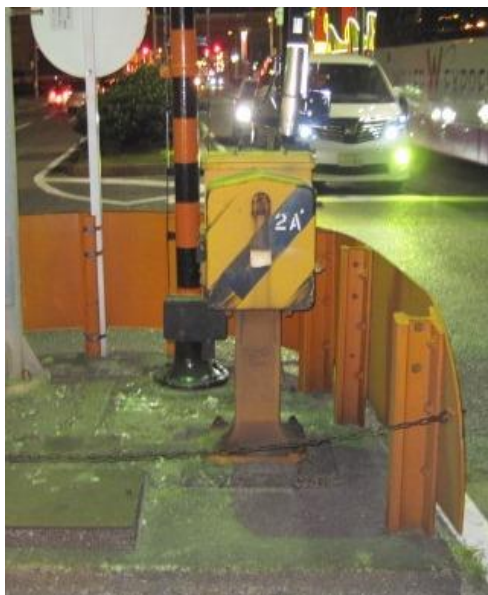
老朽化した踏切保安設備
