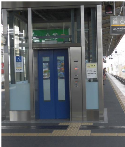
エレベーター
