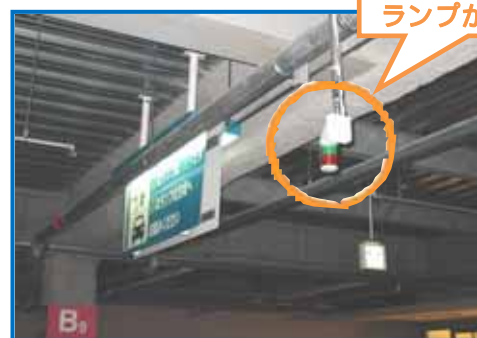
駐車場空きスペース誘導システム
