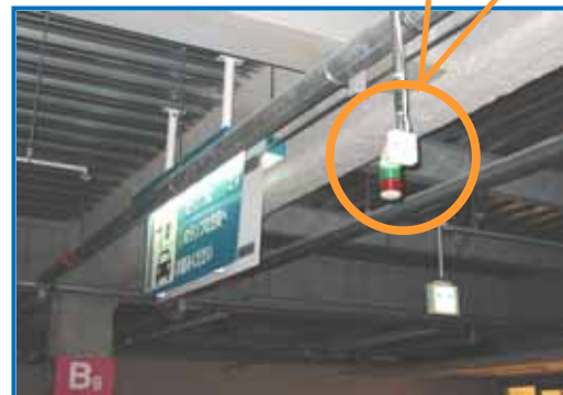
空きスペース誘導システム
