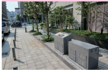
例：歴史案内版と一体化した無電柱化 の地上機器 (大阪市 道修町通)
