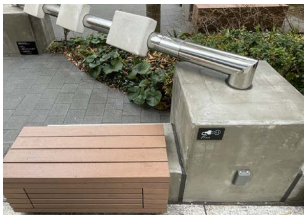
ベンチ併設のフリー電源設備
