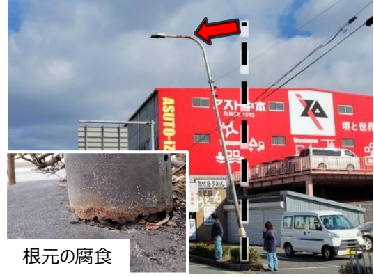
傾倒した照明灯
