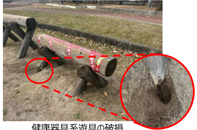
健康器具系遊具の破損
