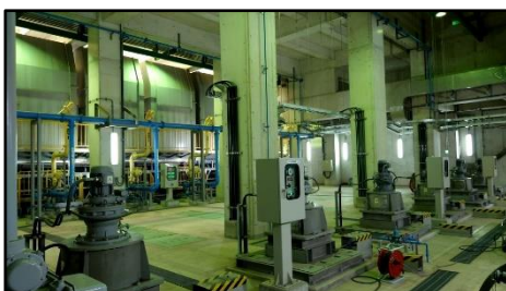
ポンプ設備（浜寺下水道ポンプ場）
