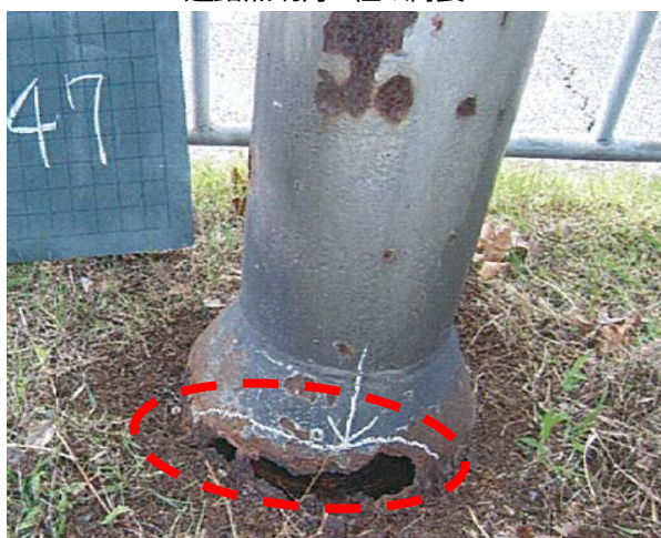
道路照明灯 柱の腐食
