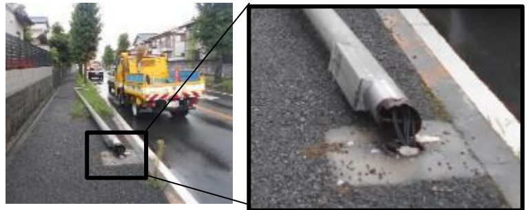
基部の腐食により倒壊した道路照明灯
