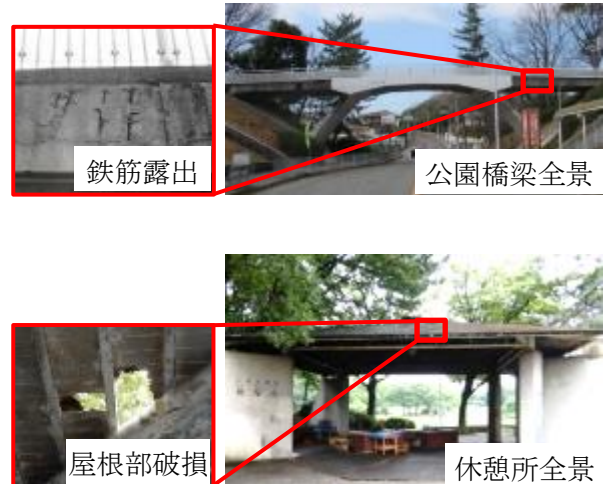
【劣化が進んだ公園施設】
