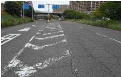
全面的にひび割れている舗装
