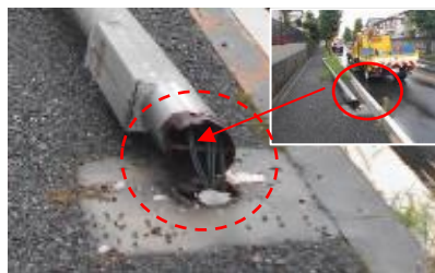
基部が腐食した道路照明灯
