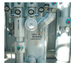
【給湯・空調の熱交換機】
