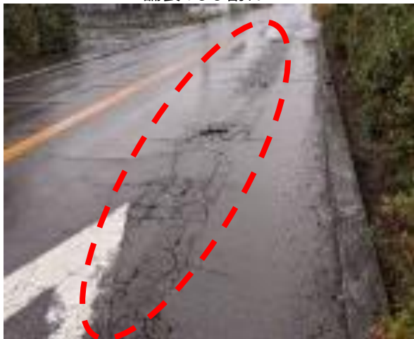
舗装のひび割れ
