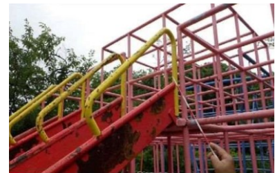
写真：老朽化した遊具
