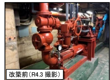
改築前(R4.3撮影) 汚泥引抜ポンプ(泉北水再生センター)
