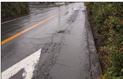
ひび割れている舗装
