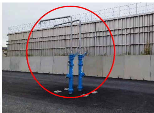
（工事後）応急給水栓 4 基の内の 2 基
