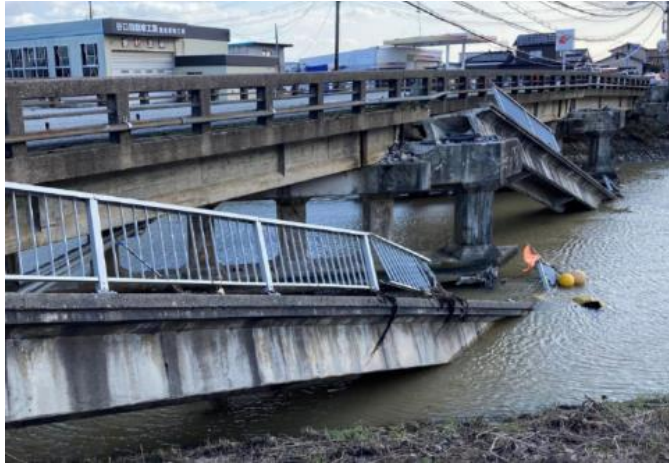
能登半島地震で倒壊した橋
