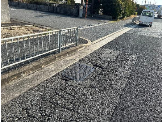
舗装のひび割れ
