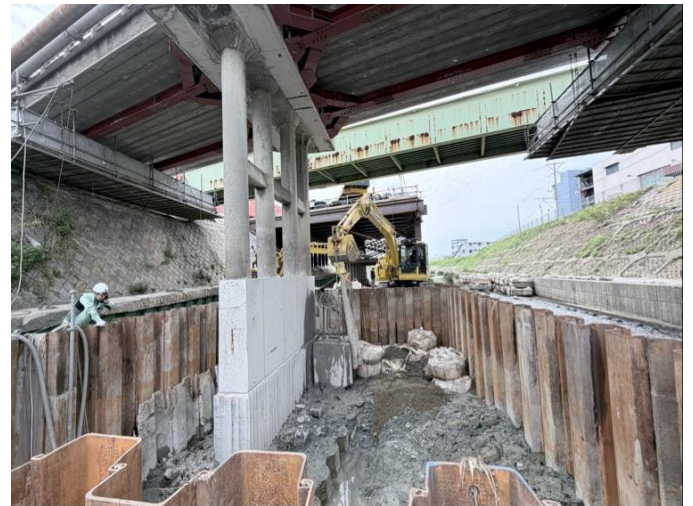
沈下が確認された橋脚
