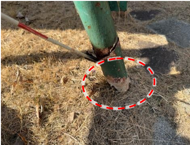
遊具安全柵の破損
