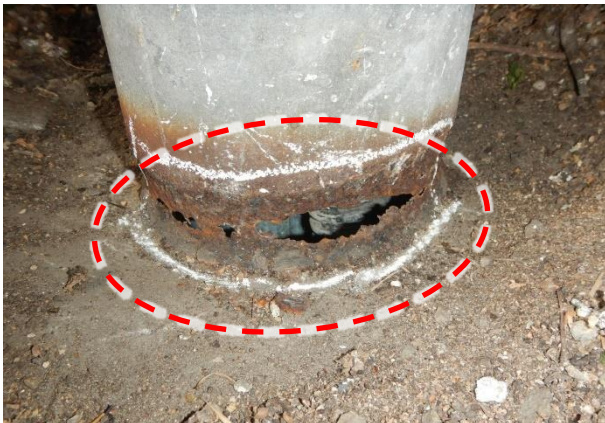
照明灯の根元の腐食
