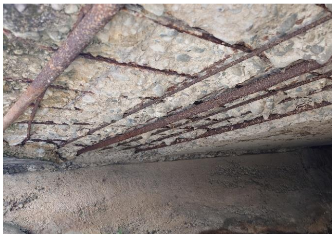
コンクリートのはく落
