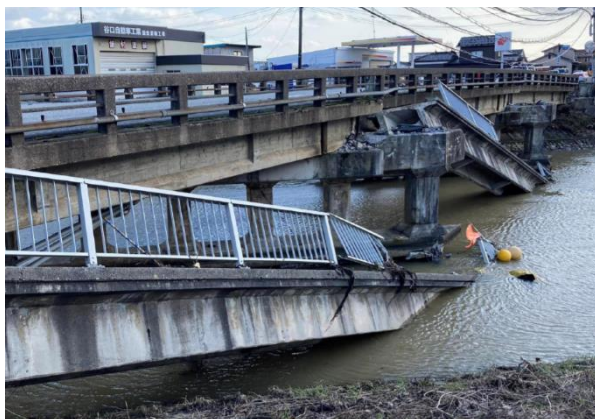
能登半島地震で倒壊した橋
