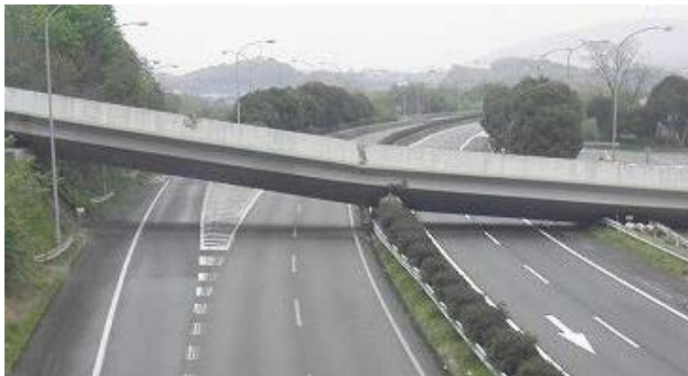
熊本地震で倒壊した橋
