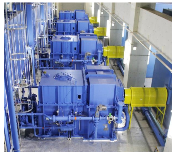
古川下水ポンプ場 雨水ポンプ原動機室
