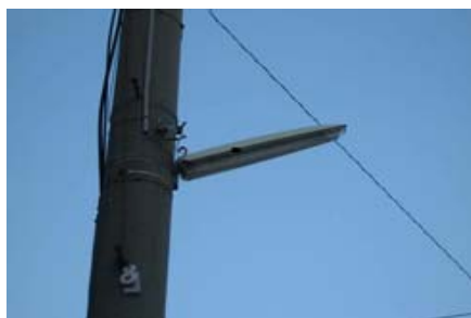
地域コミュニティに設置された防犯灯
