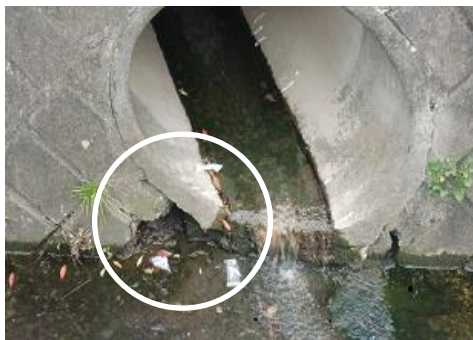
護岸損傷状況
