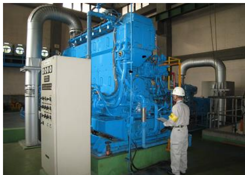
内川排水機場年次点検状況
