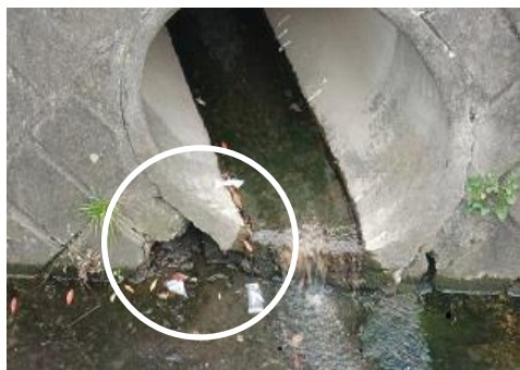
護岸損傷状況
