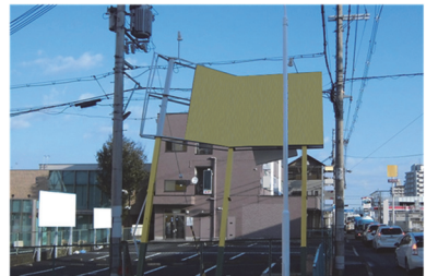
屋外広告物の板面の破壊
