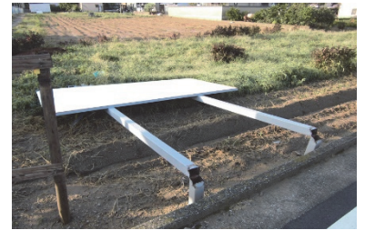
屋外広告物の倒壊
