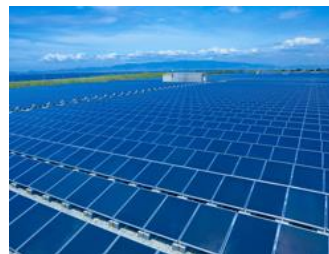
関西電力（株）堺太陽光発電所
