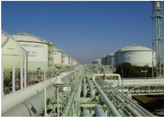
大阪ガス（株）泉北製造所
