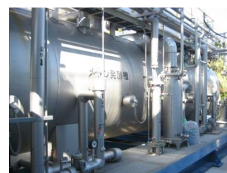
《メタン発酵施設》
