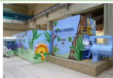
《東工場第二工場 発電設備》
