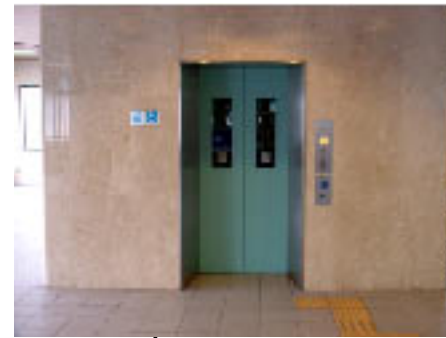
No.3 エレベーター
