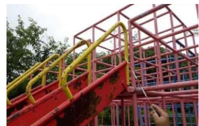
写真：老朽化した遊具
