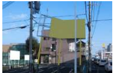
屋外広告物の板面の破壊
