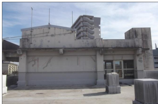
㊩(事故後)事務室棟屋上塔屋西面
