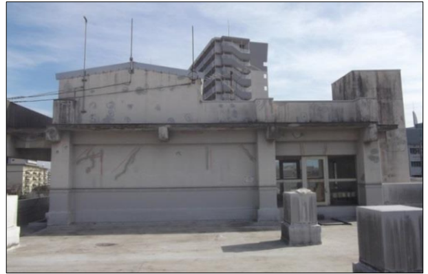
㊩ (事故後) 事務室棟屋上塔屋西面
