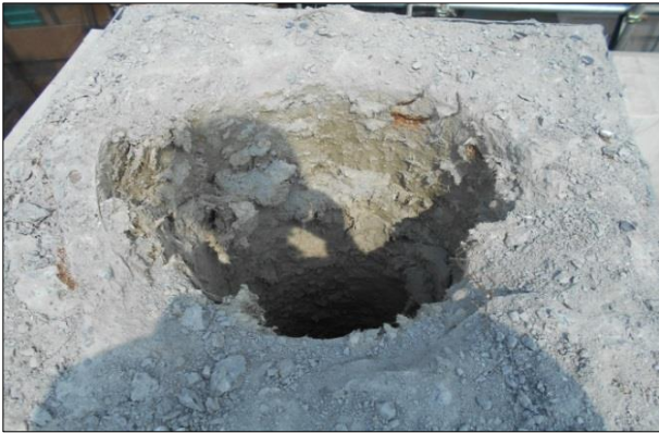
㊨ (事故後) 煙突解体後の状況 (屋上)
