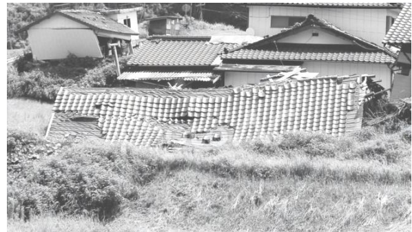
■地震による被災住宅
