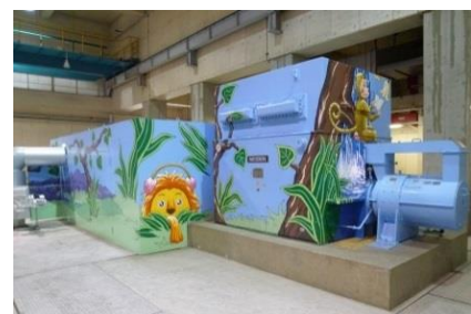
東工場第二工場発電設備
