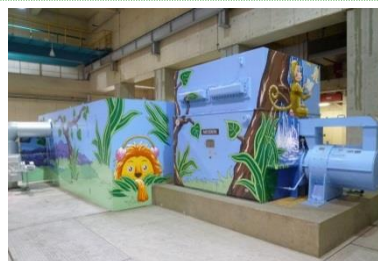
《東工場第二工場 発電設備》
