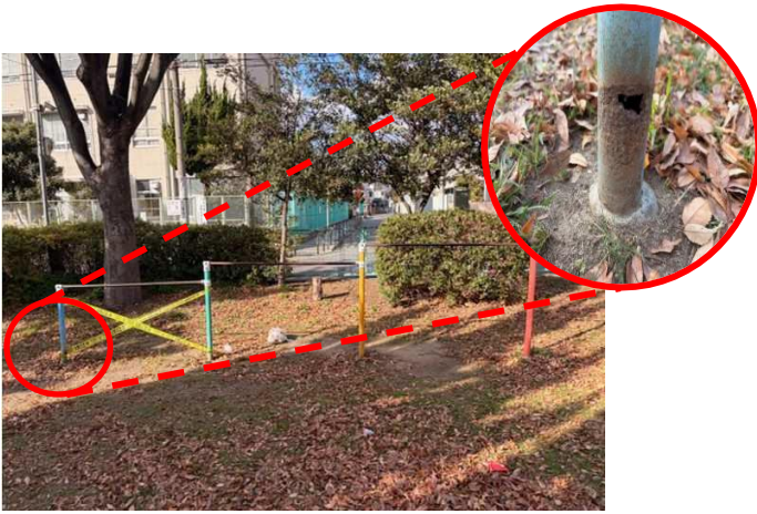
鉄棒の基礎の破損
