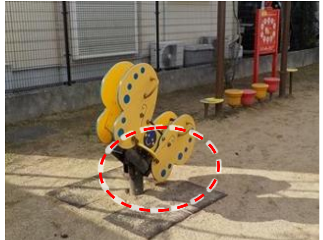
スイング遊具の破損
