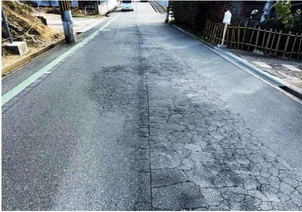
道路のひび割れ
