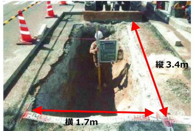
路面下の空洞
