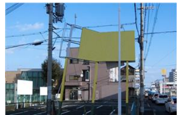
屋外広告物の板面の破壊
