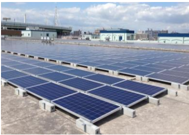
太陽光発電 （三宝水再生センター）
