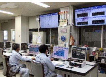
【水再生センターの運転監視】
