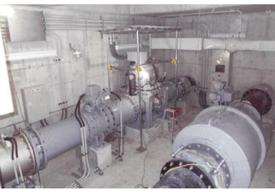
小水力発電 （陶器配水場）
