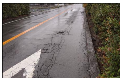
ひび割れている舗装
