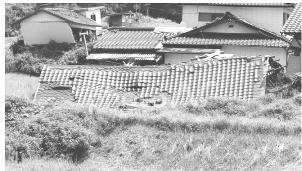
■熊本地震・被災住宅
