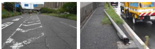
全面的にひび割れた舗装（広域緊急交通路）
