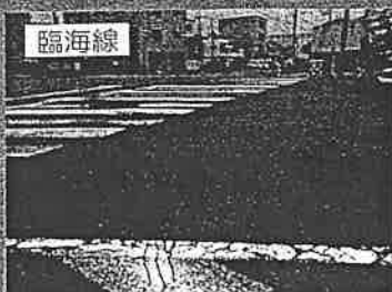
大型車の通行の度に振動を起していた路面の凹凸を舗装
