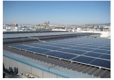
太陽光パネル
