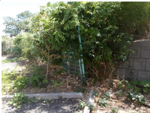
⑫から南東側隣地の越境樹木を撮影
