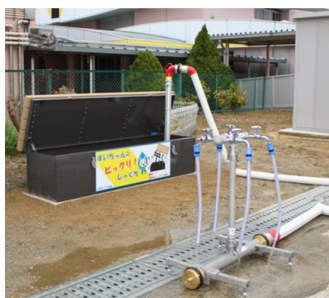
災害時給水栓
