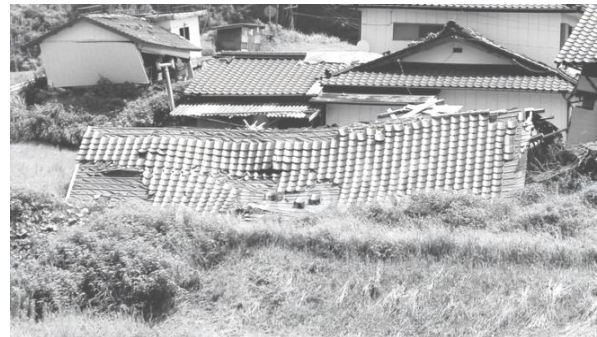
■地震による被災住宅
